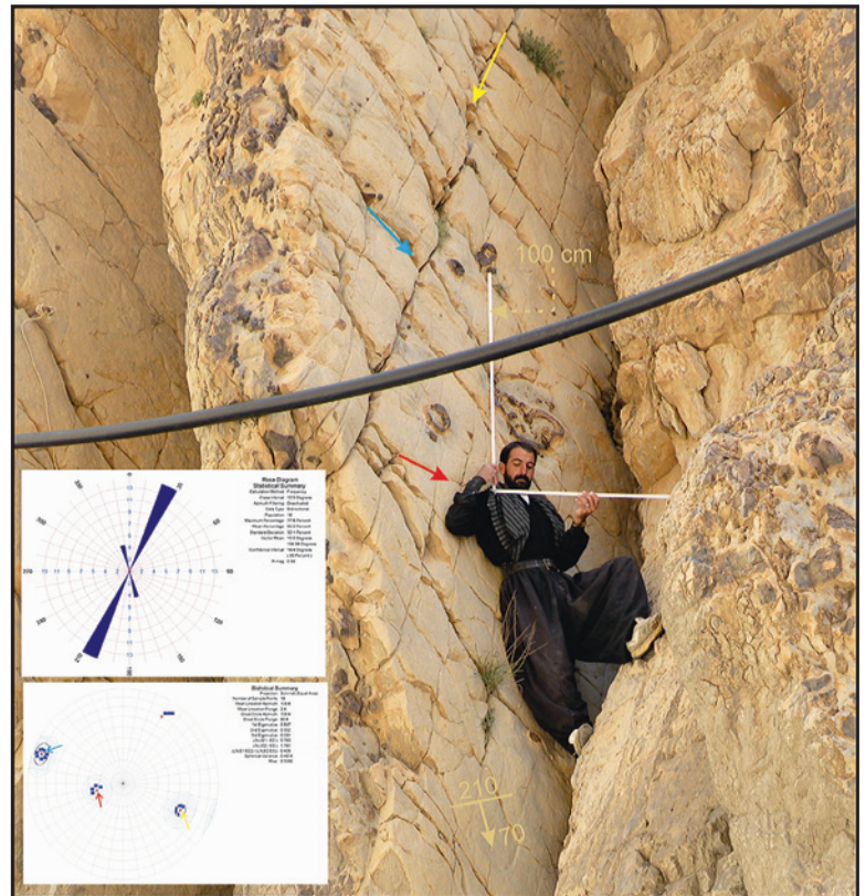
شکل ۶- وجود ۲ دسته شکستگی‌های باز با یک راستا (راستای تقریبی ۰۲۰ درجه) و دو سوی شیب متفاوت در ایستگاه شماره ۱۱ که با رنگ‌های آبی و زرد مشخص شده‌اند. همچنین یک دسته شکستگی‌های بسته (با راستای ۱۶۵ درجه) با رنگ سرخ مشخص شده است.
