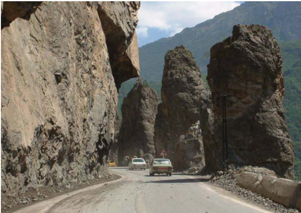
شکل ۳- نمایی از سنگ آهک ستبر لایه مبارک و توان خطر سنگ‌ریزش در مسیر راه با توجه به شیب تند دامنه
